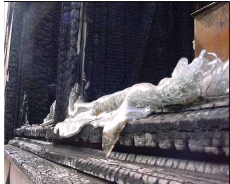
Fenêtre bois après incendie. Le verre a fondu ...
